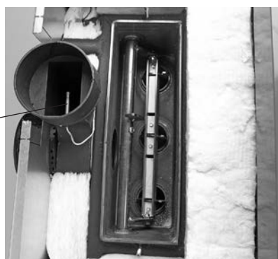
Fig. 35 Nettoyer les surfaces d'échange supérieures
